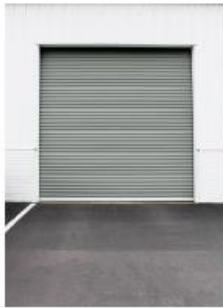
F-4 STORAGE UNIT ROLL UP DOOR
